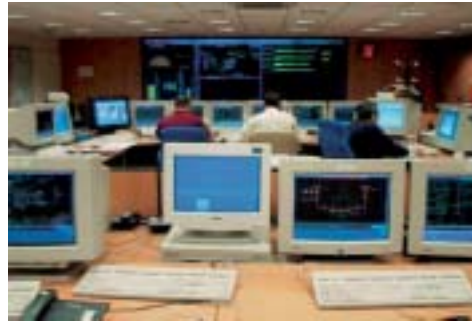
Figura 3. Despacho central de generación
