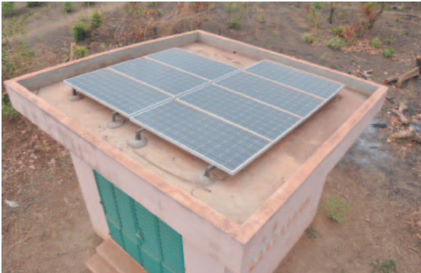
Caseta para la bomba y paneles solares.
