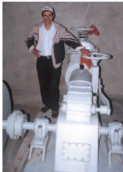
Ejemplo de turbina de una central minihidráulica en Perú.
